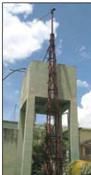
Figure 65. Photo à gauche : Château d'eau de 40m 3 Zeïna Hydro
