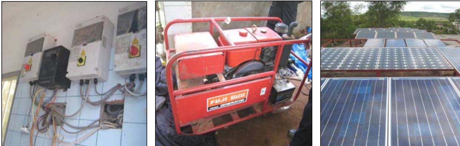
Figure 72. Composants des différents systèmes électriques de pompage du réseau Zeïna Hydro (De gauche à droite : tableau de commandes des pompes, groupe électrogène, panneaux solaires)
