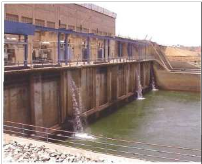
Figure 10 : Barrage hydroélectrique de Sélingué, le Niger, une artère vitale , RIZA, Wetlands international, IVM, 2005
